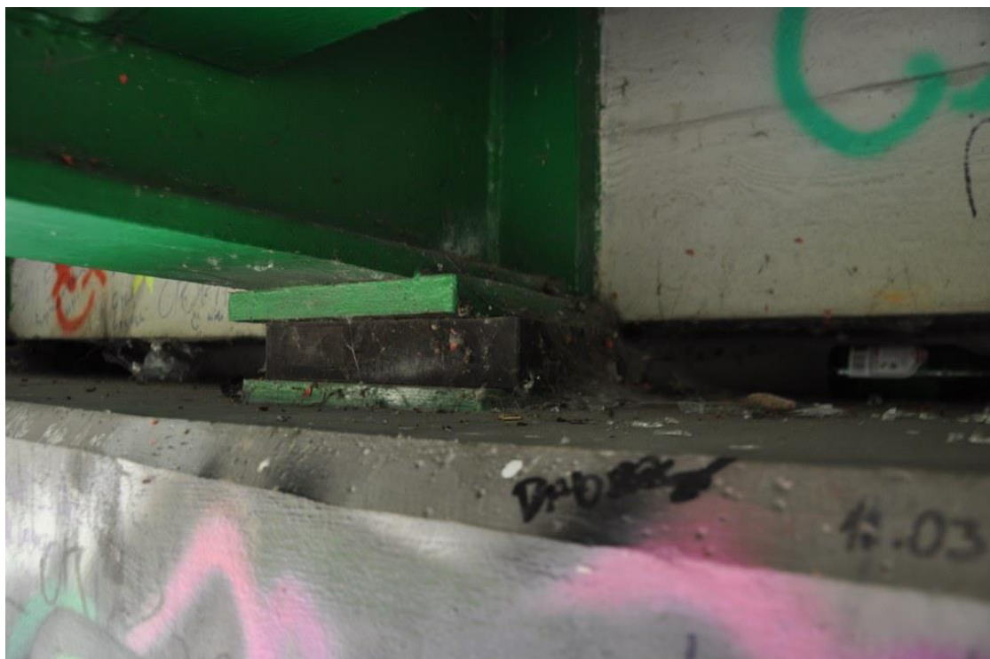
Zdjęcie nr 3 – Widok na przemieszczone łożysko elastomerowe w osi nr 1.
