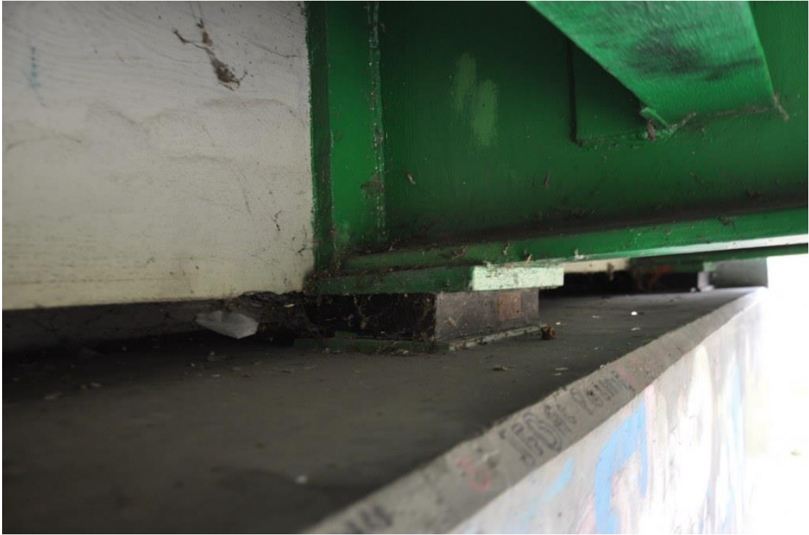
Zdjęcie nr 7 – Widok na przemieszczone łożysko elastomerowe w osi nr 4.
