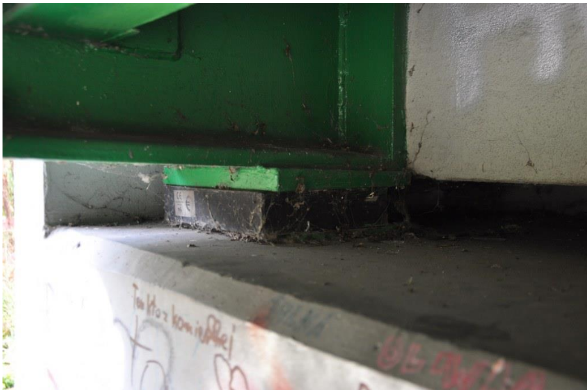
Zdjęcie nr 6 – Widok na przemieszczone łożysko elastomerowe w osi nr 4.
