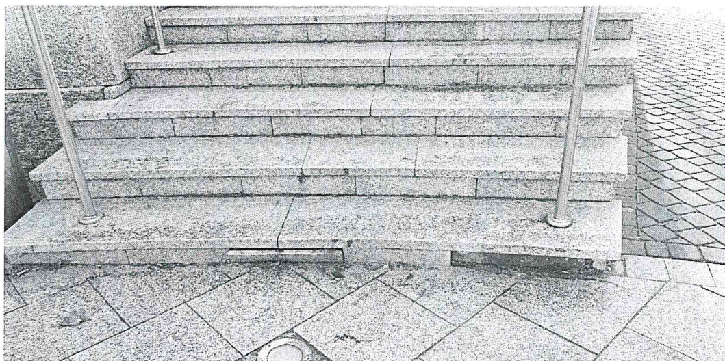
Fot. 4 Uszkodzenia schodów od strony wschodniej.
