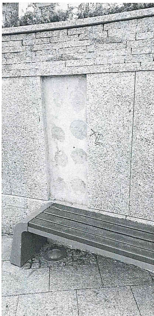
Fot. 5 Brak płyty granitowej w murze oporowym.
