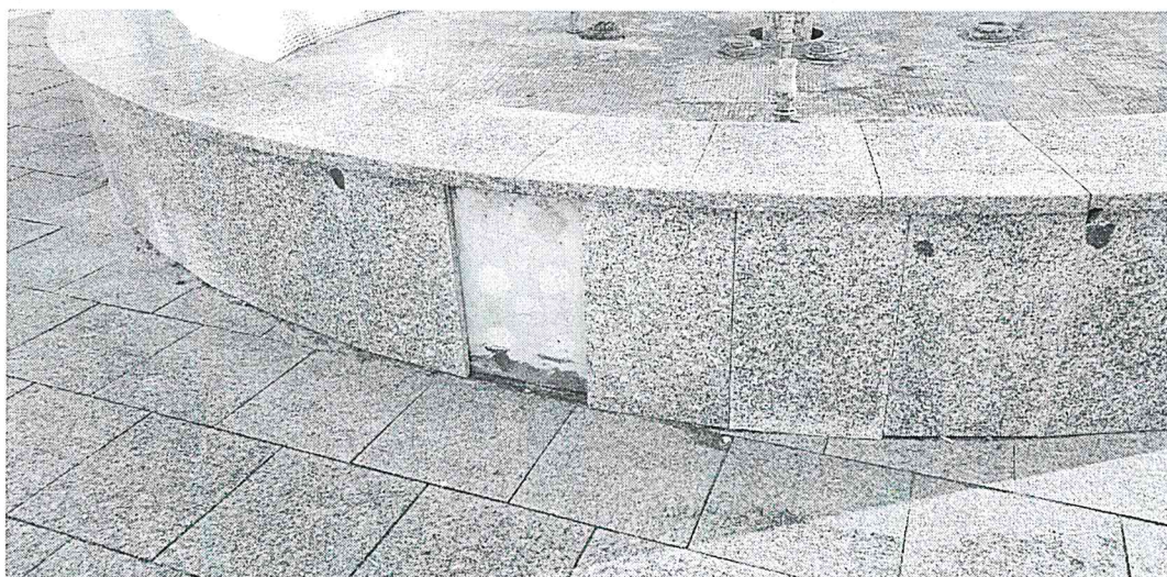
Fot. 2 Brak płyty granitowej. W dolnej części widoczna powłokowa izolacja bitumiczna.
